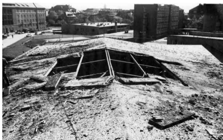
Uszkodzony dach auli.
